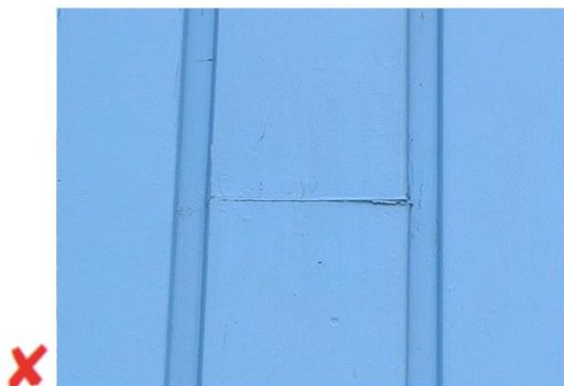
Afbeelding 8 - Stuiknaden fout gemonteerd (Bron: Centrum Hout, 2024)
